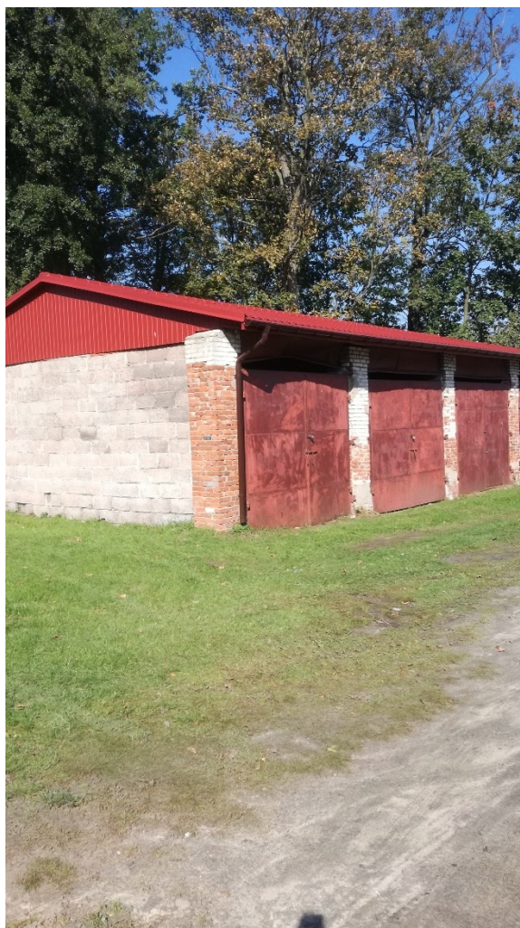
Magazyn na placu – elewacja do remontu (Gmina w 2013 roku wymieniła pokrycie dachowe)
