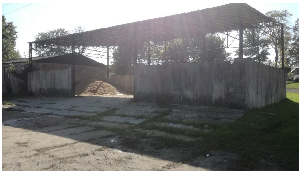
Wiata na piach – do rozbiórki
